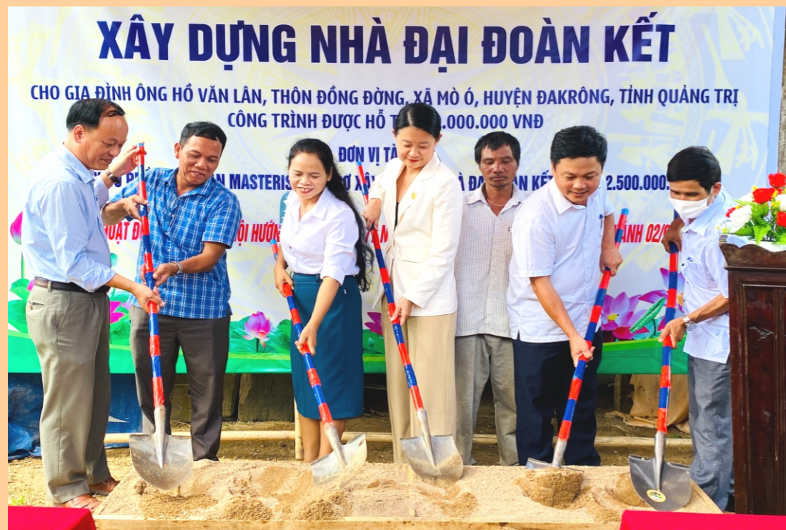
Phó Chủ tịch Ủy ban MTTQ Việt Nam tỉnh Lê Hồng Sơn khởi công xây dựng nhà đại đoàn kết cho bà Hồ Văn Lân, ở xã Mô Ó, huyện Đakrông. Đây là 1 trong tổng số 50 ngôi nhà đại đoàn kết do Tập đoàn Masterise hỗ trợ xây dựng với tổng kinh phí 2,5 tỉ đồng. Ảnh NP
